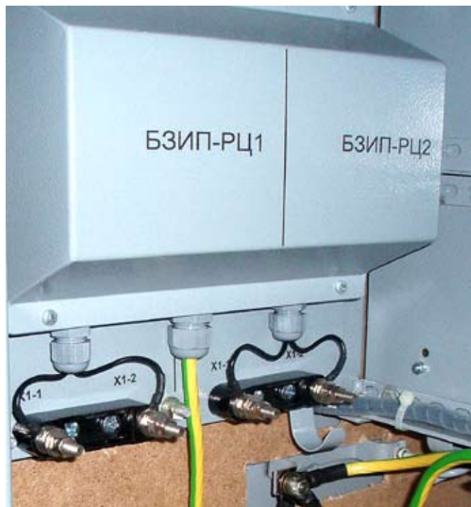
Рис. 4. Блок защиты по рельсовым цепям (БЗИП-РЦ)
